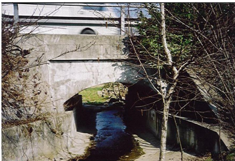
Immagine 2 – Ponte, attraversamento corso d'acqua su SP342, alla pk 30+650 (foto 2 elaborato G.3)
